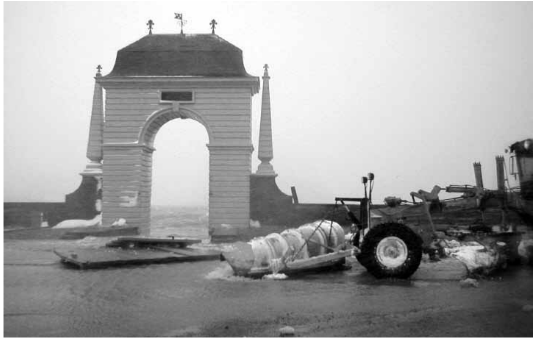
Dégâts causés par une tempête d'hiver à la porte Frédéric. Parcs Canada – Ian Harte
