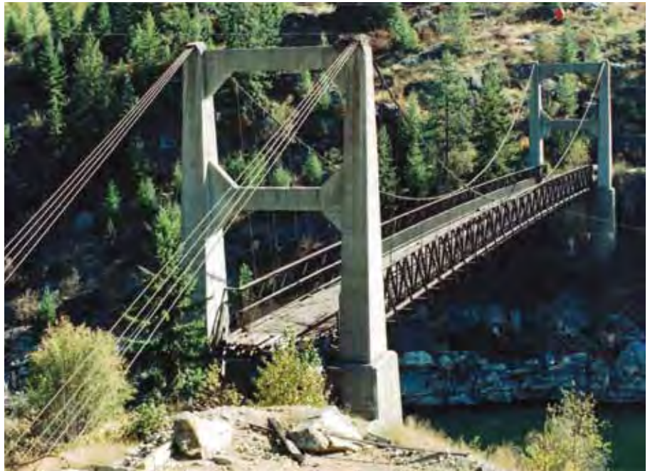
Le pont suspendu de Doukhobor, près de Castlegar, en Colombie Britannique, est un exemple d'ouvrage de génie civil auquel se rattache une valeur culturelle symbolique importante. Construit par les membres de la collectivité de Doukhobor, il représente une réalisation ambitieuse pour une collectivité de pionniers et témoigne des capacités considérables d'un groupe qui mise sur l'effort collectif.
