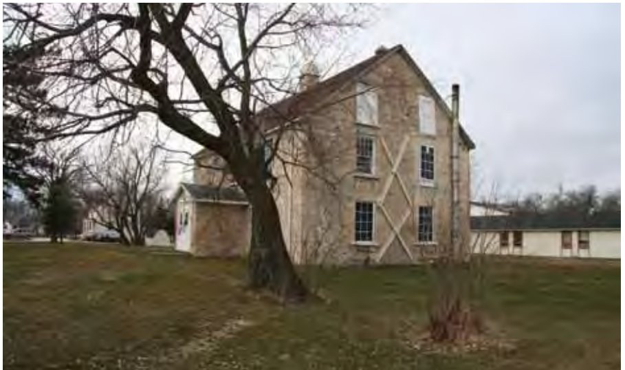
Il est important d'adapter les interventions de stabilisation temporaire à la durée de vie prévue de l'intervention et de la rendre aussi facilement réversible que possible. Des supports temporaires en acier soutiennent un mur extérieur du St. Peter's Dynevor Anglican Church Rectory à Selkirk, au Manitoba.
