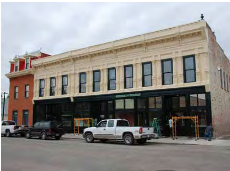
La façade est après la restauration des devantures de magasin et la préservation de la façade en tôle embossée. Entretien (peinture) en cours.
