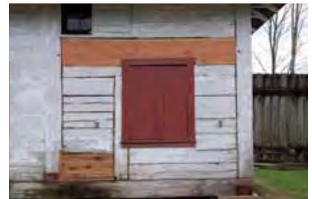
Une évaluation de l'état des murs extérieurs et de la structure de cet entrepôt de Fort Langley, en C.-B., a permis de constater une grave détérioration de certaines pièces de charpente, qui doivent être remplacées à l'identique. Les dimensions et l'espèce de bois dressé à la hache correspondent au matériau d'origine. Les photographies montrent une partie d'un mur de l'entrepôt après les réparations mais avant que le nouveau bois ne soit blanchi à la chaux.
