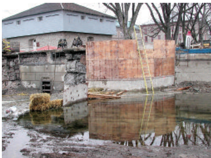
En raison du climat que connaît la région, les structures de pierre calcaire du canal exigent une surveillance et un entretien réguliers.
